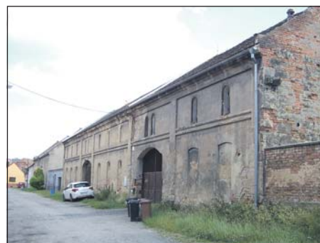
V této staré stodole v Denisovské ulici by mělo vzniknout nové zázemí zlonické technické čety.
