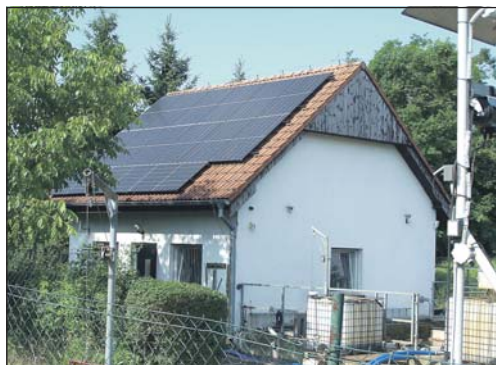
Fotovoltaické panely na střeše provozní budovy zlonické ČOV.
