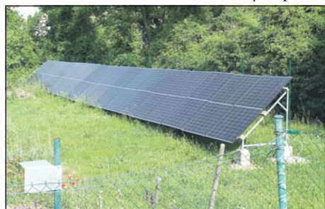
Další solární panely se nacházejí hned vedle budovy ČOV.
